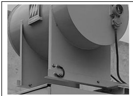
Figura 84: Unión tanque conservador con tanque principal
